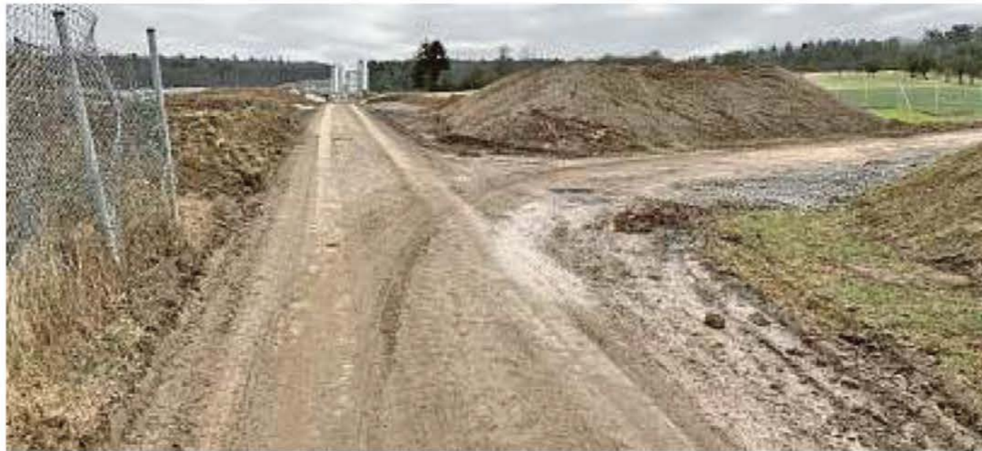
Viel Dreck auch beim Zwischenlager für Erdmassen auf den Feldern gegenüber der Rastanlage: Die Baufirma hat zugesagt, den Weg zu säubern.
