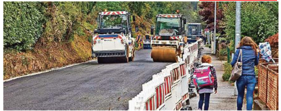
Im Slalom gehts durch die Baustelle im Neuenbürger Stadtkern. Seit gestern sind die Bauarbeiter zwischen Abzweig Enzring und Reutweg unterwegs. FOTOS: MORITZ
